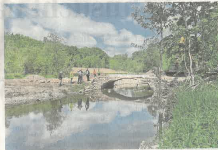
Im Rahmen des Auen-Projekts wird nun ein neuer Durchlass am Osterkampsredder errichtet. Die Freigabe des Wanderwegs erfolgt im Laufe des Junis.
